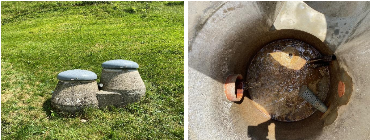
Abb. 4.7 und 4.8: Quellschacht Näppis 2 (Fotos L&H; 29.6.2022)
