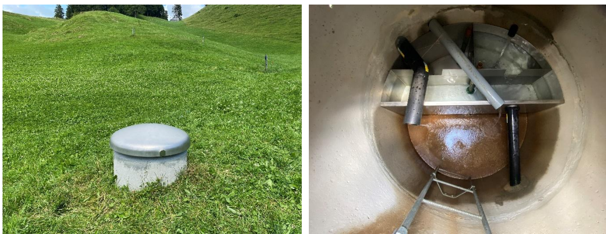
Abb. 4.11 und 4.12: Sammel-schacht Näppis 2 (Fotos L&H; 29.6.2022)
