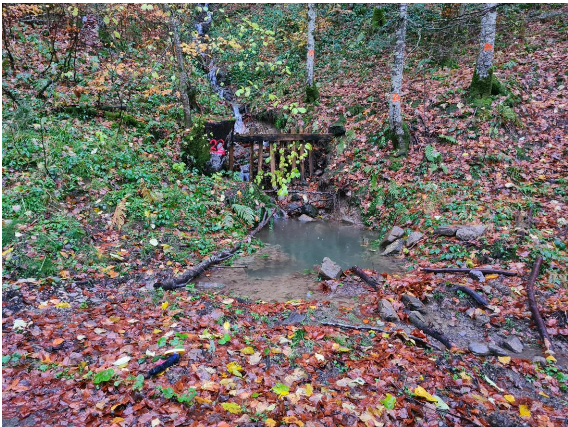
Abb. 3: Verklauster Durchlass nach Starkniederschlägen
