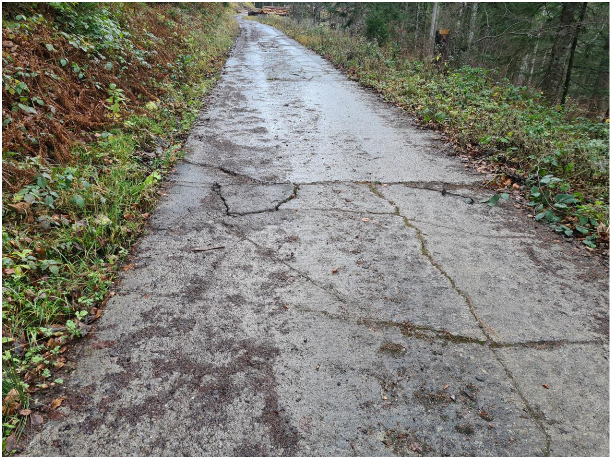
Abb. 9: Mehrfach gebrochene Betonplatten
