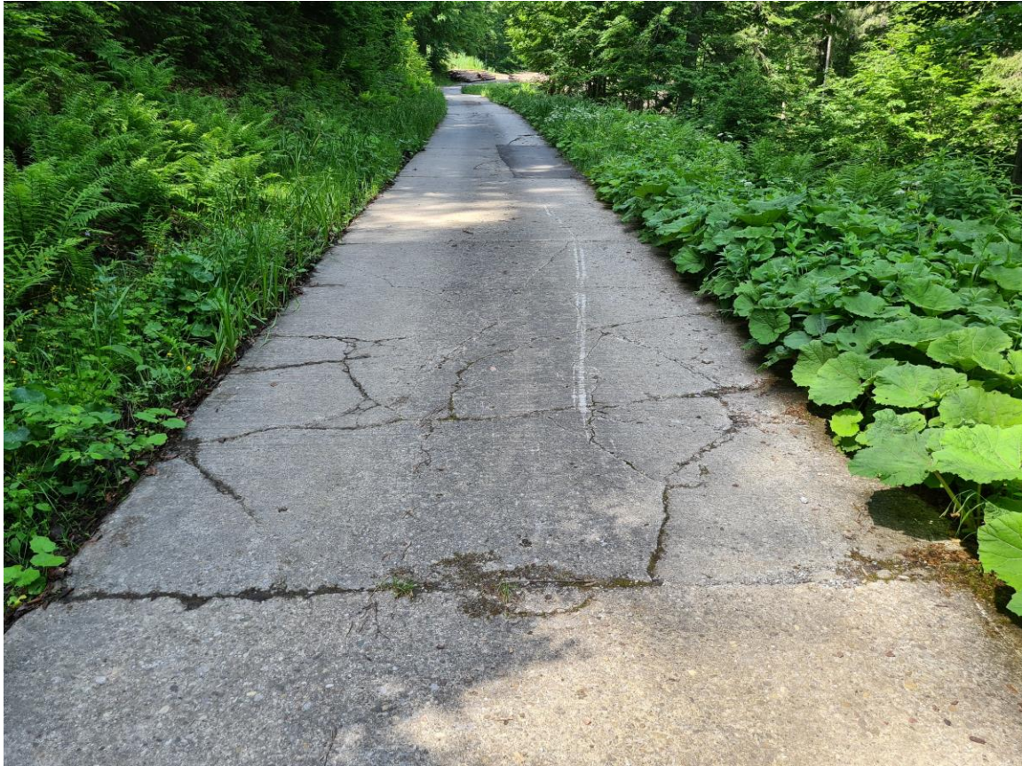
Abb. 2: Gebrochene Betonplatten (Foto: M. Ammann, 17.06.2022)
