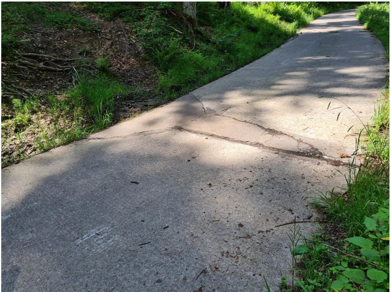
Abb. 11: Lokal beschädigte Betonplatte
